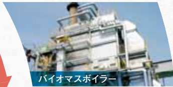
バイオマスボイラー
