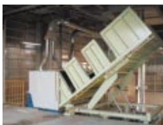
木屑を燃料チップとしてリサイクルするために木屑破砕装置を設置
