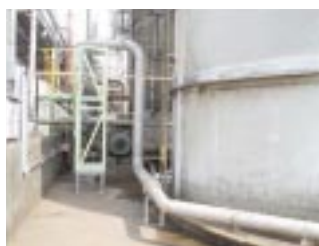
タンクの底に沈降する残渣を無くするために、タンク下部に水流を発生させる装置を設置
