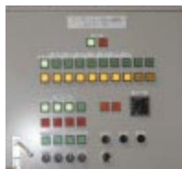
コンプレッサー稼働の制御パネル
