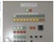
コンプレッサー コントロールパネル
