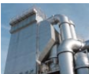
煤塵捕集装置
