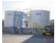
排水貯蔵タンク
