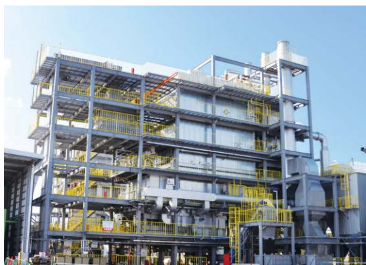
増設した岡山工場のバイオマスボイラー
